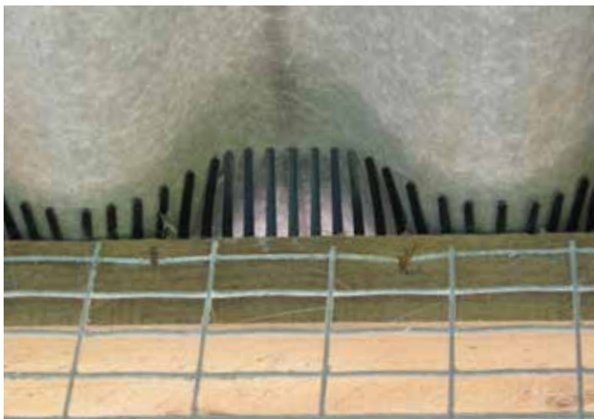
Vogelschutzmaßnahmen, Quelle: Mayringer, LK OÖ
