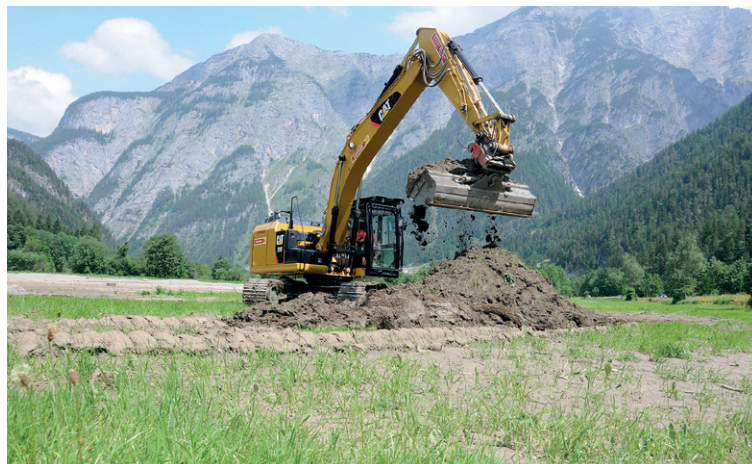
DAS HEURIGE HOCHWASSER hat am Grünland viel Schlamm und Kies hinterlassen. Mit der Behörde ist abzuklären, ob das Material verwertet werden kann oder als Abfall eingestuft werden muss.
